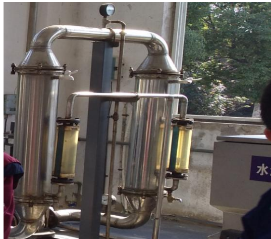
破乳气浮预处理
