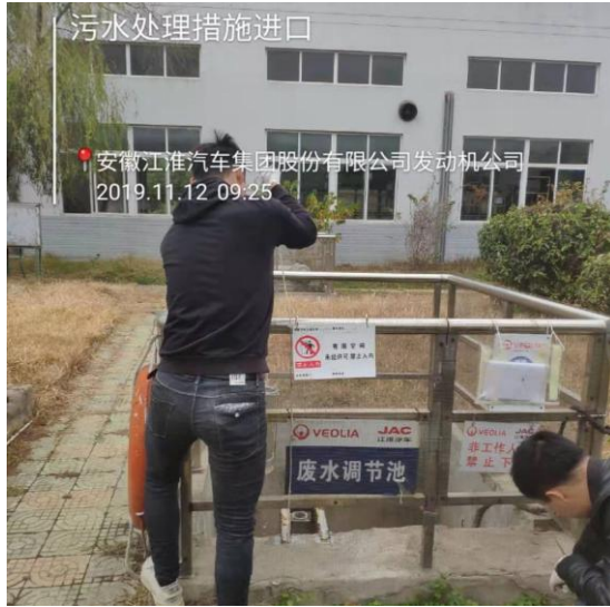
厂区废水处理设施进口
