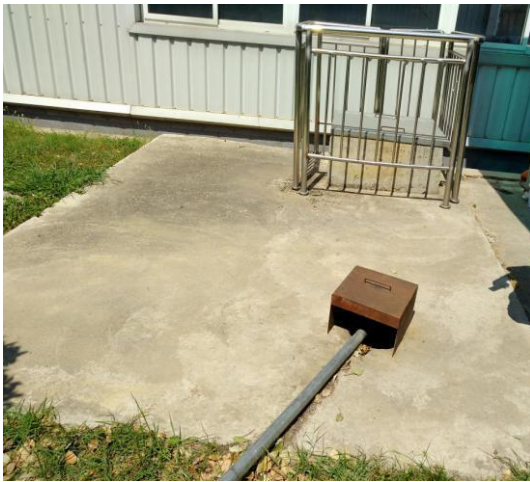
清洗废水收集池
