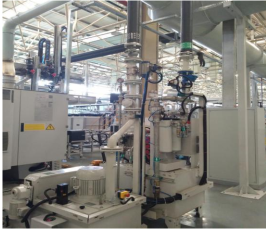
项目乳化液循环系统
