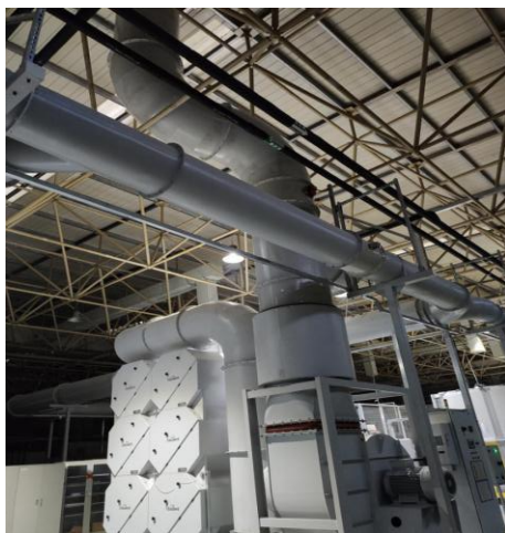
油雾净化设施
